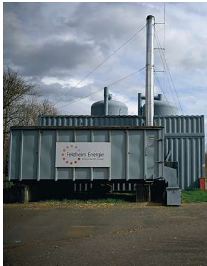
La production énergétique de Feldheim est aussi assurée par un système de chauffage aux copeaux de bois.
