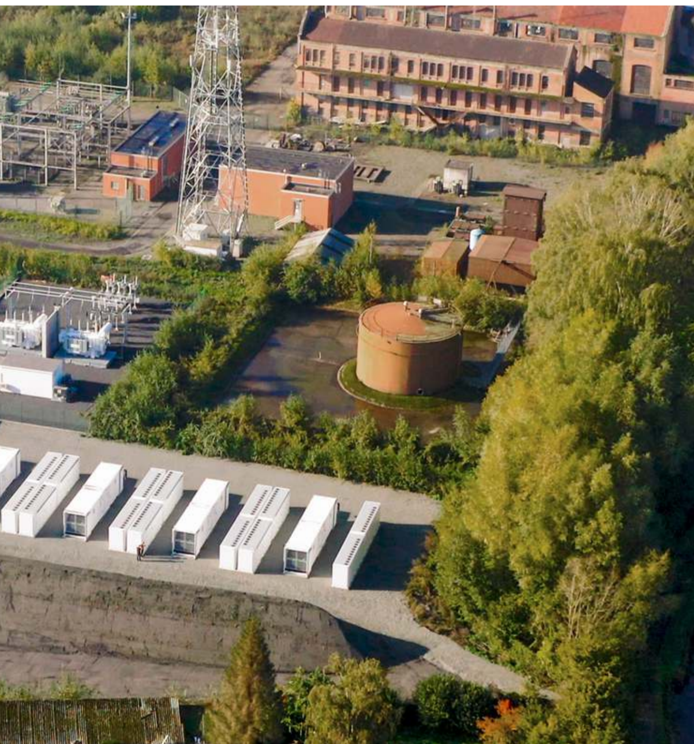
Le parc de batteries de Corsica Sole mis en service en décembre 2022 à Deux-Acres a une puissance de 50 W et peut délivrer de l'électricité pendant deux heures (100 MWh). Il utilise 40 batteries lithium-ion « MegaPack » de Tesla et a représenté un investissement de 33 millions d'euros. © D.R.
