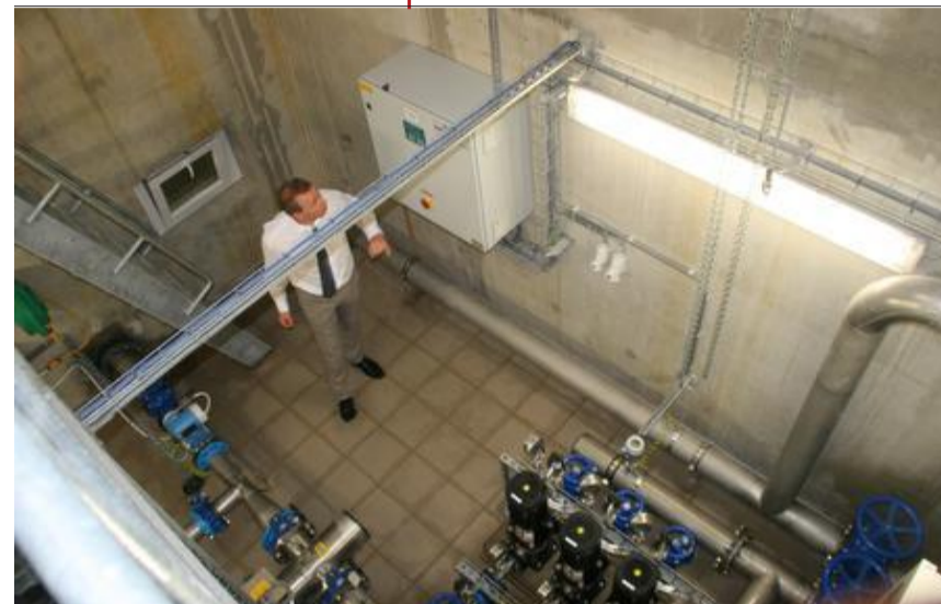
Dans les entrailles d'une station souterraine de captage de l'eau... © J.-L.B.
